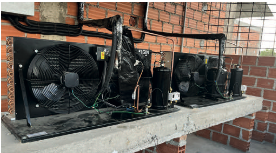
Foto 10.26. Sala de máquinas de cámara frigorífica, FRUTA DE MI TIERRA – Vallegrande (gentileza Mario Rocabado).
