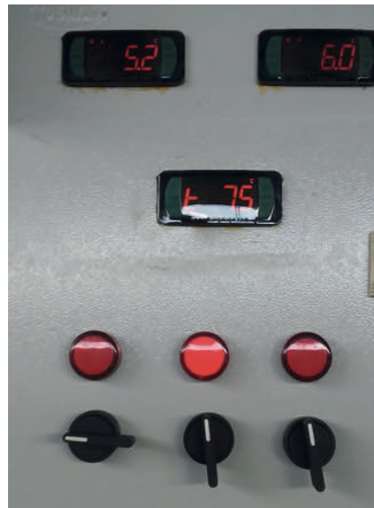
Foto 10.28. Equipo de control y monitoreo de la cámara de frío.
