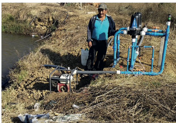
Foto 5.3. Cabezal de riego por goteo.
